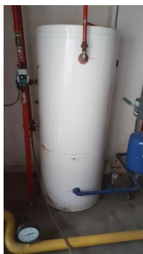
Fig 5. Boiler de apă caldă de consum
